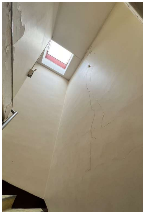
Fot. 1 Zdjęcie pęknięcia pionowego w ścianie klatki schodowej budynku oficyny – poziom +2
