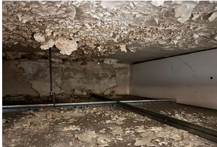
Fot. 2 Zniszczenia stropu balkonu dziedzińca – poziom 0
