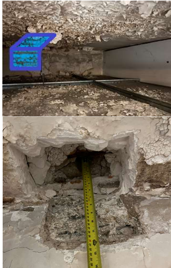
Fot. 4 Odkrywka stropu poziomu 0 nad kuchnią
